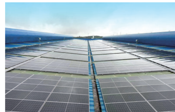
山河工业城光伏系统
