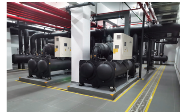
山河工业城总部大楼整栋采用地源热泵空调系统
