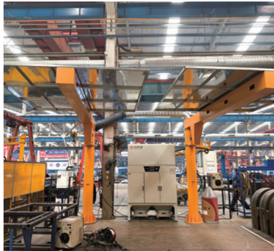
焊接烟尘收集处理设施改造
